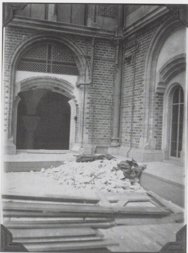
Afb. 10. De oostelijke binnenplaats in het najaar van 1931 kort voor de aanvang van de betonnering en verbouwingwerkzaamheden.
